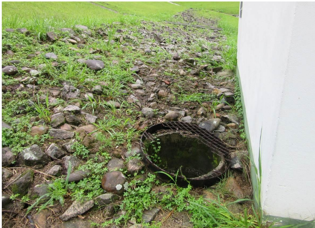
Fotografia 18 – Poço de inspeção que se encontra junto a ensecadeira, no pé do talude de jusante, atrás da edificação existente no local.
