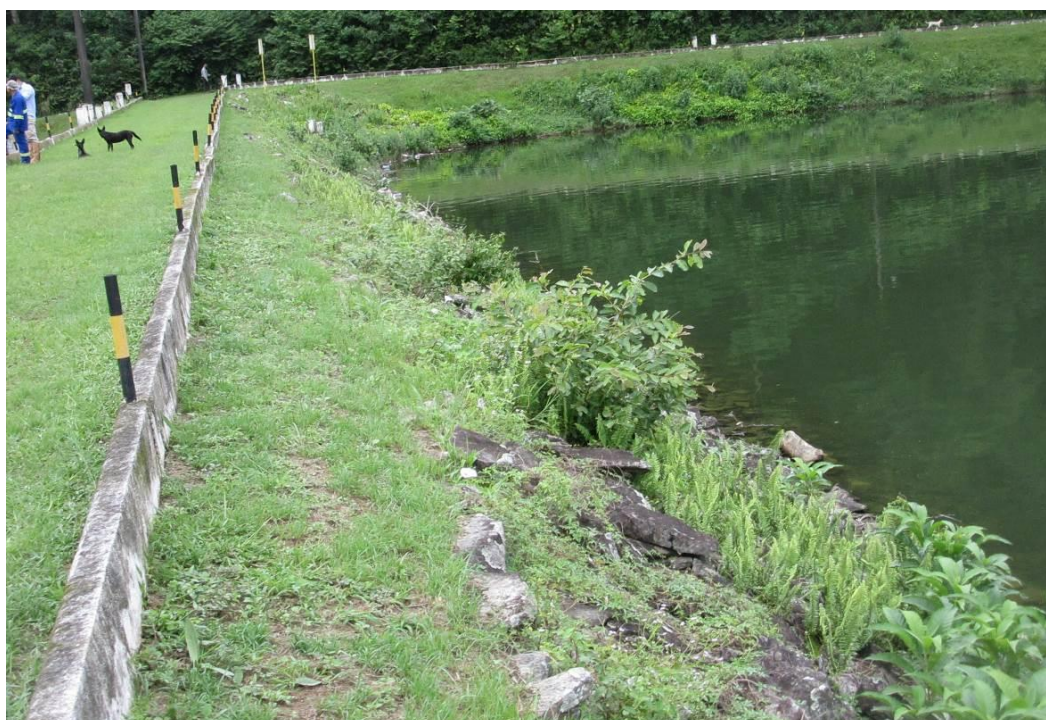
Fotografia 2 – Vegetação de gramíneas e arbustos encobrendo trechos do enrocamento.
