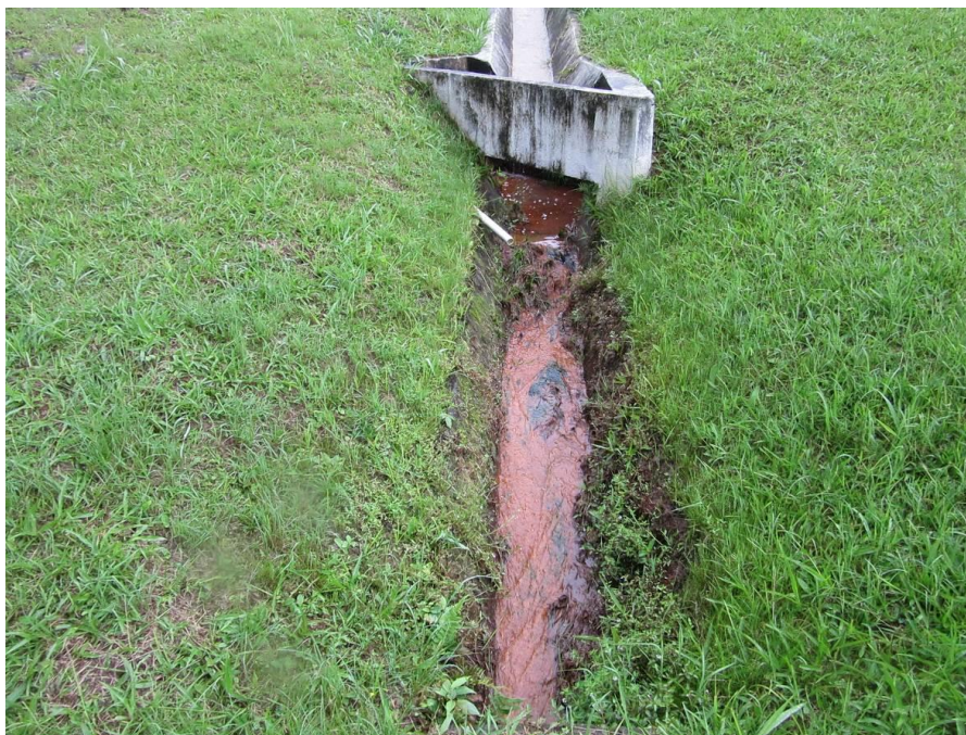
Fotografia 10 – Dreno no pé do talude de jusante do filtro da barragem carreando um material fino de coloração avermelhada.
