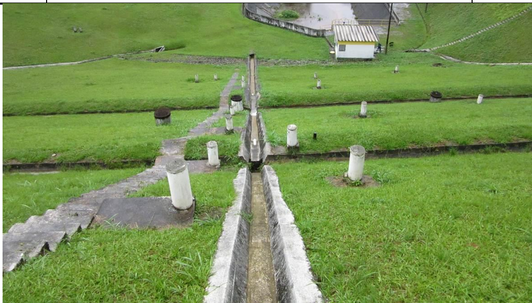
Fotografia 20 – Vista de parte dos instrumentos de monitoramento instalados no talude de jusante do barramento.
