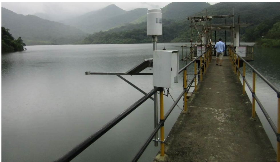
Fotografia 22 – Pluviômetro e medidor de nível d'água instalados junto à passarela da torre de tomada d'água.
