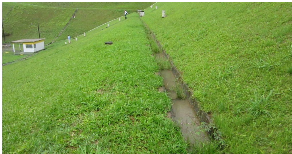
Fotografia 9 – Restos vegetais de gramíneas obstruindo as canaletas de drenagem.
