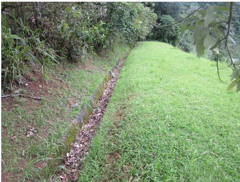
Fotografia 15 – Restos vegetais encobrendo a canaleta de drenagem superficial da ombreira esquerda a jusante do barramento.
