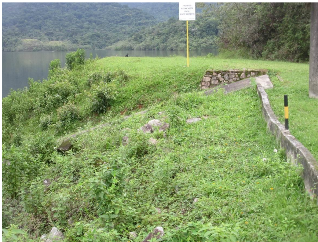
Fotografia 3 – Vegetação de gramíneas e arbustos encobrendo trechos do enrocamento.
